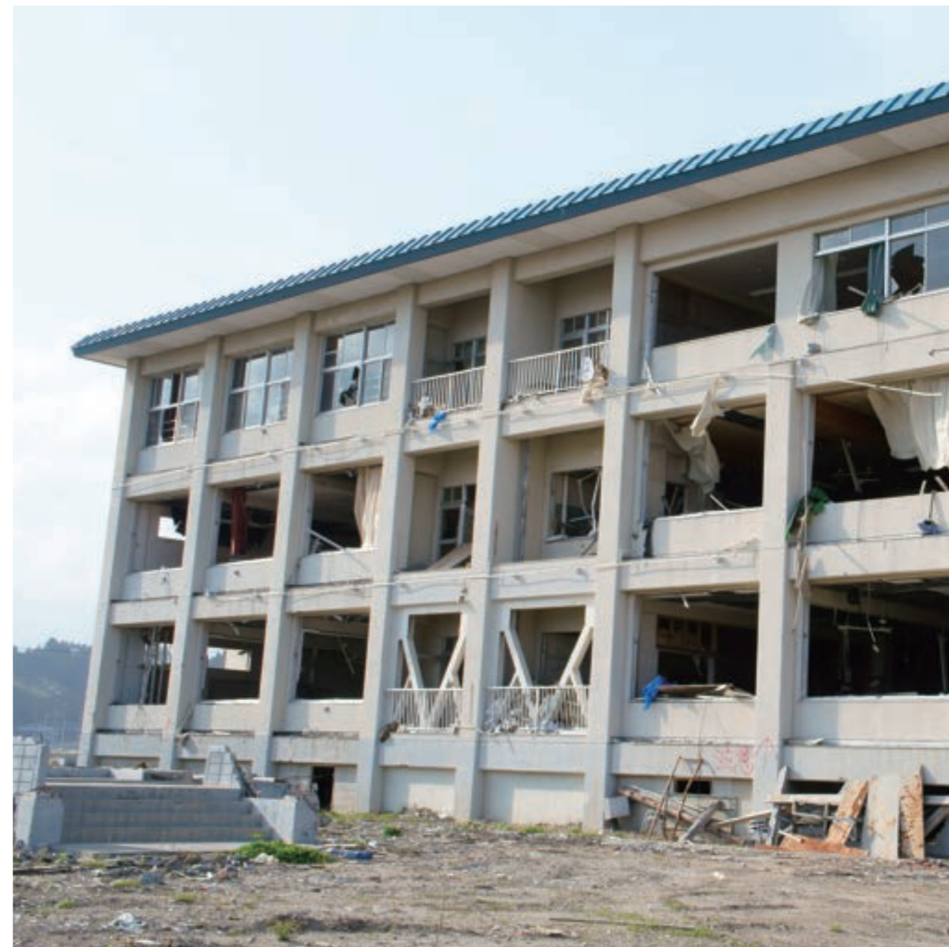
2011年に発生した東北地方太平洋沖地震による建築基準想定内の被災
