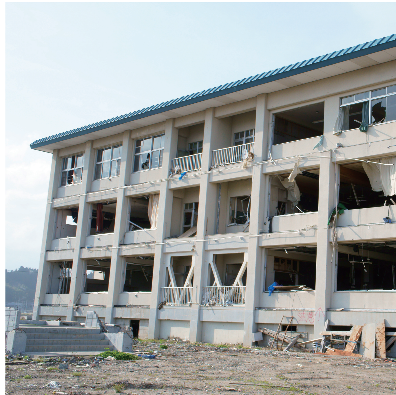
2011年に発生した東北地方太平洋沖地震による建築基準想定内の被災
